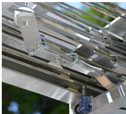
sistema di sicurezza rottura fune
